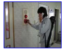
防災設備点検
